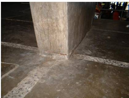
Figura 07 – Piso inadequado para a acessibilidade. Fonte: Acervo Próprio
