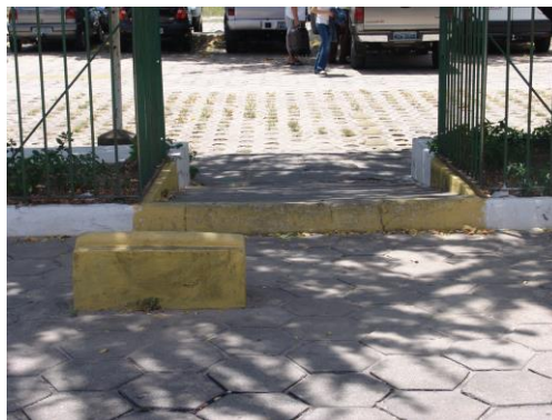
Figura 04 – Desníveis existentes na transição do estacionamento para a via interna de circulação de veículos. Fonte: Acervo próprio
